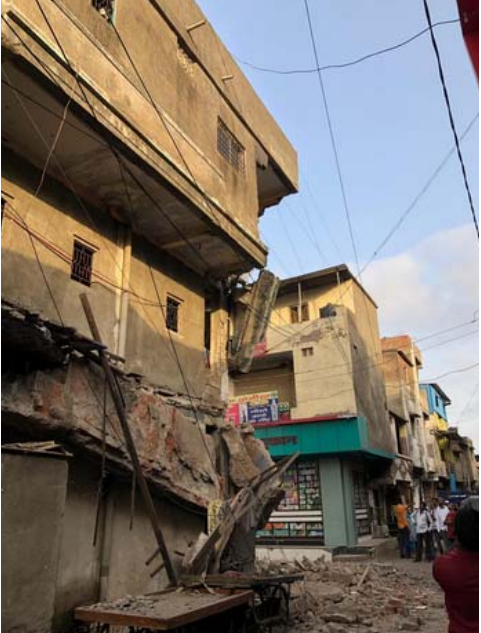
सूत। उन चार रास्ता के पास रोड़ पर एक जर्जर बिल्डिंग का एक हिस्सा धराशायी हो जाने से अग्निशमक दल की टीम ने घटानस्थल पर पहुंच कर बिल्डिंग के बाकी बचे जर्जर भयजनक हिस्से को गिराने का काम समाचार लिखे जाने तक जारी है।
